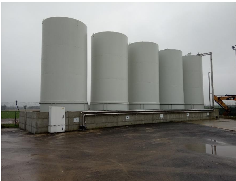
Silos di accumulo del percolato
